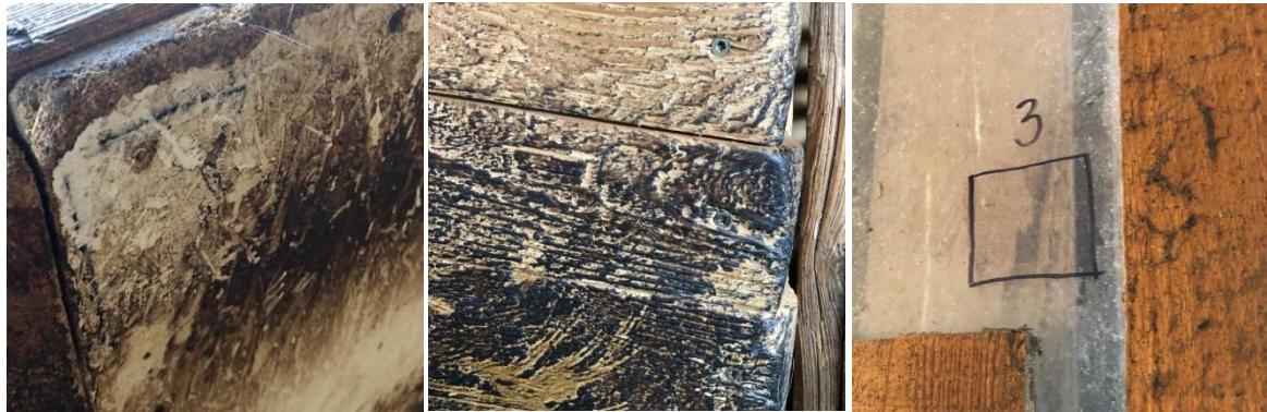
Abbildung 8: v.l.n.r Probestelle 1 (Holz), Probestelle 2 (Holz), Probestelle 3 (Kunststoff)
